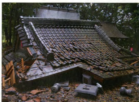
【拝殿】被災直後の様子
