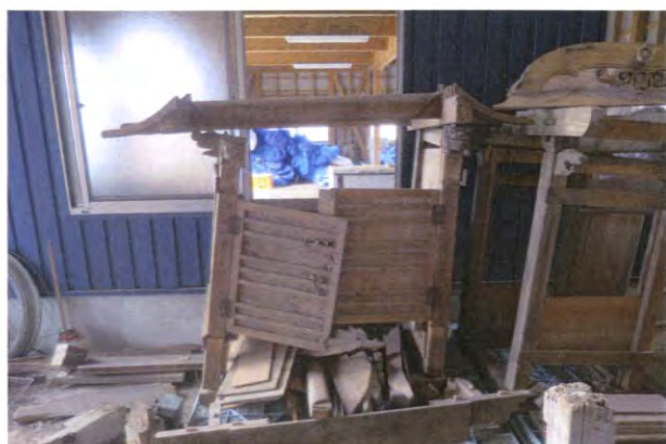
⑦ 大破した本殿の空殿
