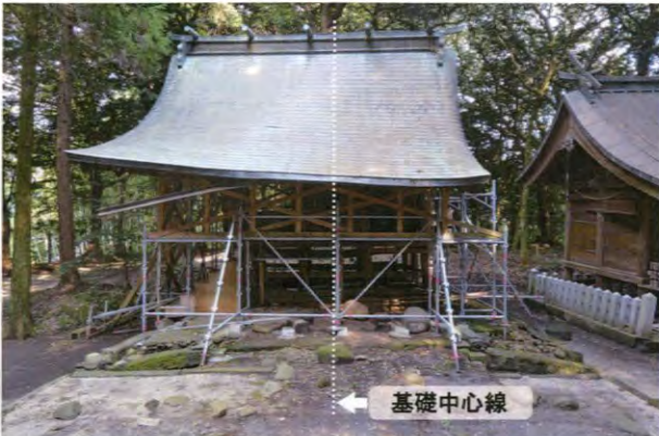
① 解体前の本殿正面。屋根が躯体から外れ、北側に大きくズレていました。
