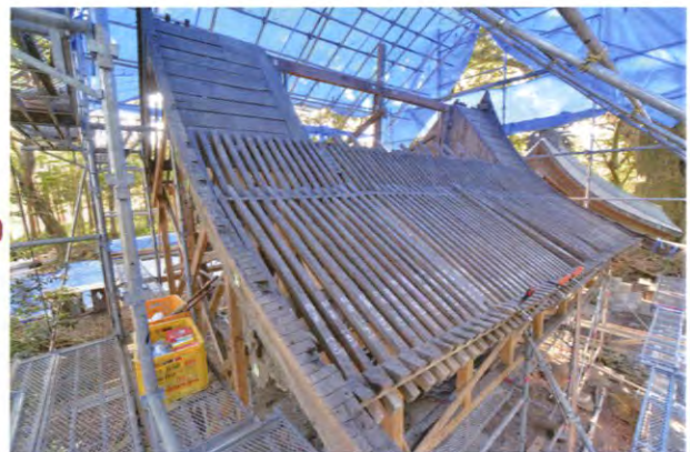
③ 垂木や野地板の解体状況。著しい漏水は見られず、比較的健全な状態を保っていました。
