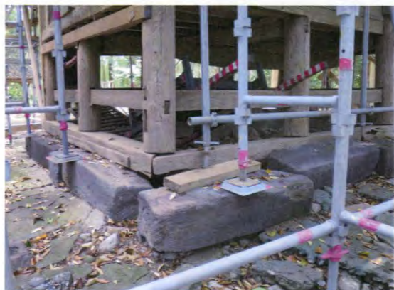
【本殿】倒壊した基礎石と滑動した躯体
