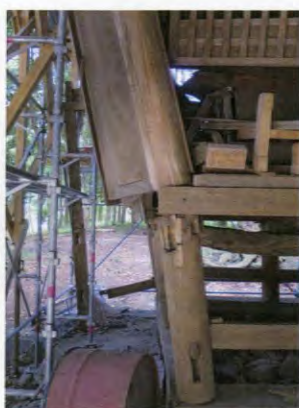
【本殿】折損した隅柱
