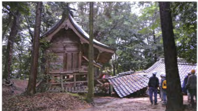
【八王社本殿・幣殿】被災直後 北面
