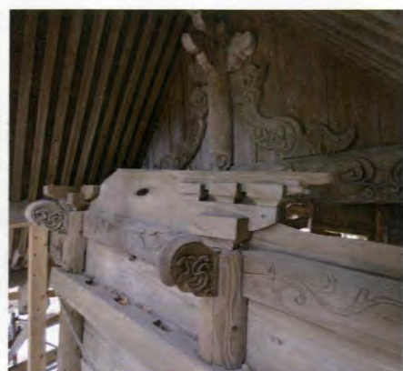
【本殿】軸組から脱落した屋根組
